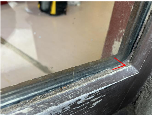
004 : Mastic vitrage PF coulissante Salle motricité (niv:0) - PRE:FRG003
