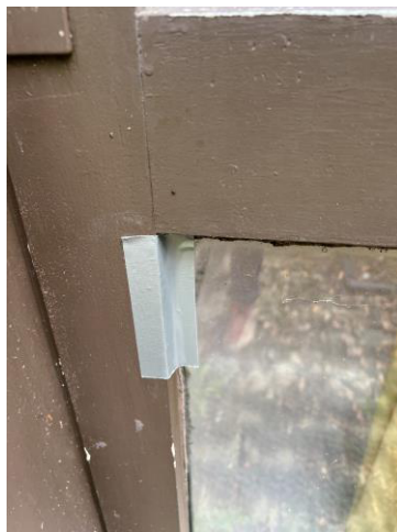
021 : Mastic vitrage Porte fenêtre Hall (niv:0) - PRE:FRG015
